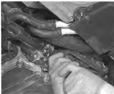
④ ウォーターポンプ部分のホースを外してクーラントを排出させる
